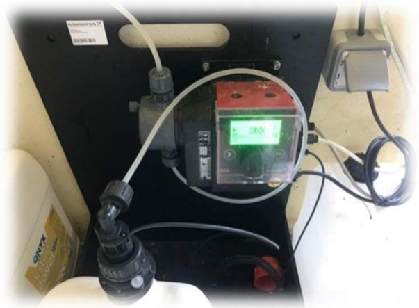
Pompe doseuse de chlore
